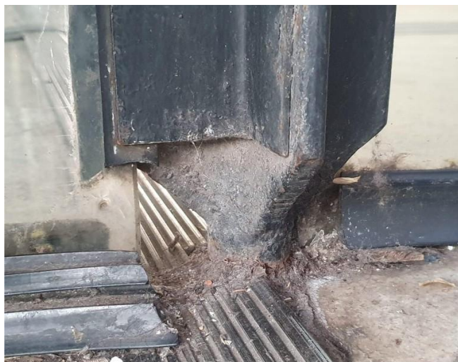
Foto 1: Fixação inferior feita por chumbamento do por solda à mesa inferior montante no piso. viga metálica
